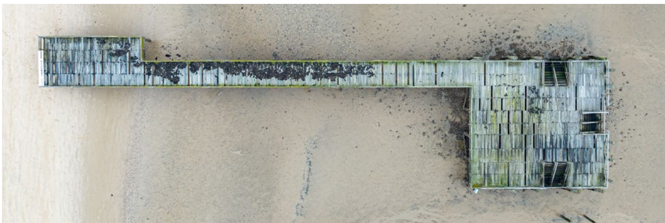
Die marode Mittelbrücke Ende November 2022: Selbst leichte Sturmfluten überspülen die Brücke und verursachen Schäden.
